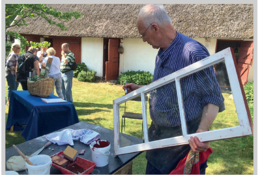
Pålssonshuset, Malmö. Pierwsza konserwacja po 30 latach.
